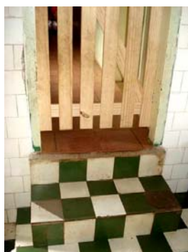
Pavimento térreo - desnível existente entre o corredor e a copa.
