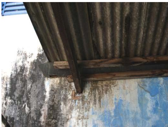
Bolor de umidade na parede externa da escada. FOTO: Natália B.Campos, dez. 2007.
