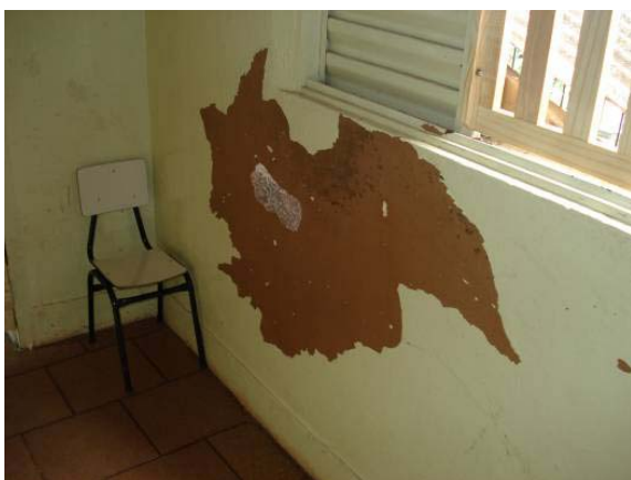
Desprendimento da tinta no corredor central. FOTO: Natália B.Campos, dez. 2007.
