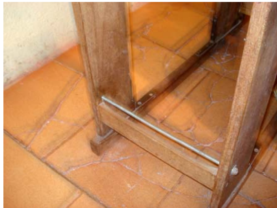
Piso em cerâmica quebrado devido a sobrecarga. FOTO: Natália B.Campos, dez. 2007.
