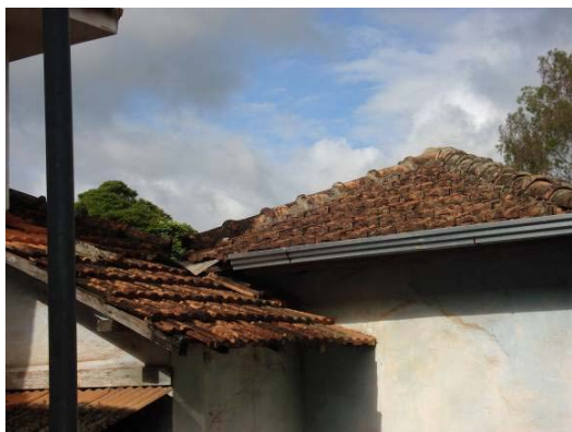
Desalinhamento e telhas quebradas no telhado. FOTO: Natália B.Campos, dez. 2007.
