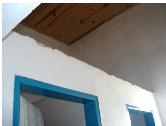
Pavimento térreo - quarto 06, banheiros. Detalhe para a inexistência de forros. FOTO: Natália B.Campos, dez. 2007.
