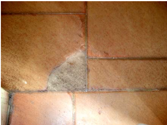
Piso em cerâmica parcialmente quebrado. FOTO: Natália B.Campos, dez. 2007.
