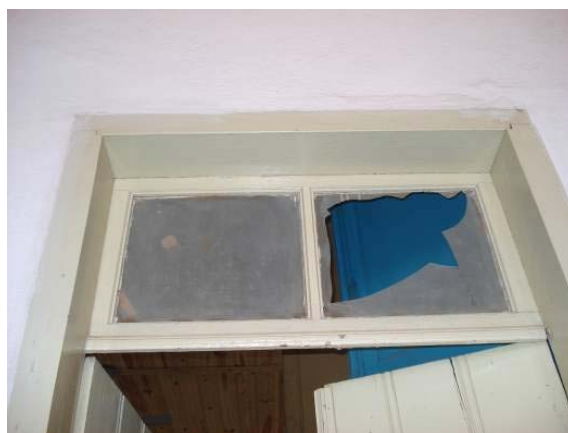
Vidro quebrado localizado acima da porta da diretoria. FOTO: Natália B.Campos, dez. 2007.
