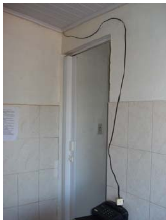
Detalhe da fiação que passa na cozinha. FOTO: Natália B.Campos, dez. 2007.
