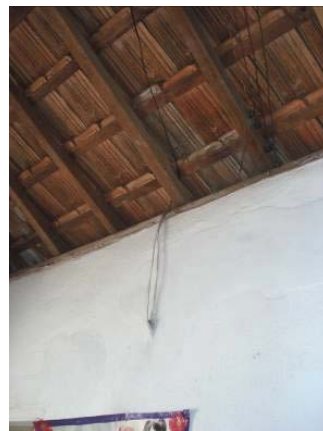
Detalhe da fiação que passa na copa. FOTO: Natália B.Campos, dez. 2007.
