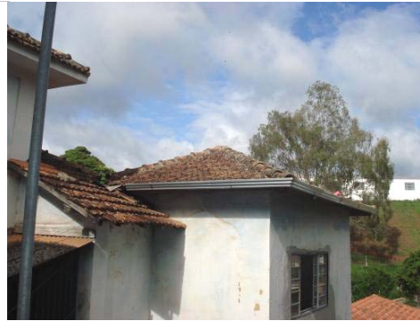
Desníveis no telhado colonial. FOTO: Natália B.Campos, dez. 2007.
