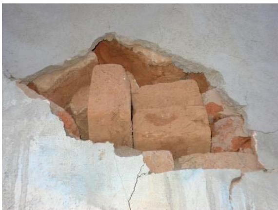
Rombo na fachada posterior, preenchido com tijolo. FOTO: Natália B.Campos, dez. 2007.
