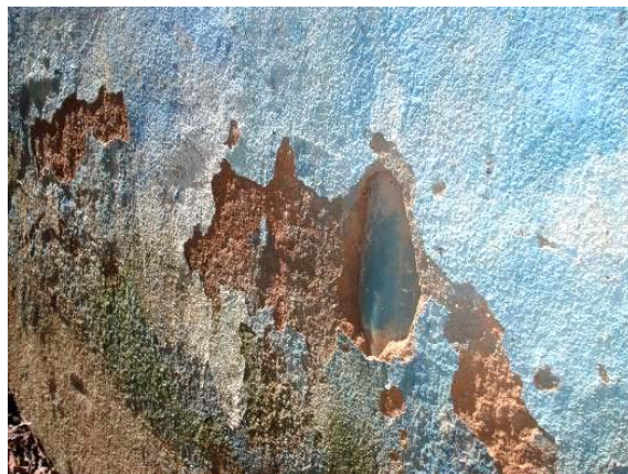
Lacuna na alvenaria localizada na fachada lateral esquerda. FOTO: Natália B.Campos, dez. 2007.
