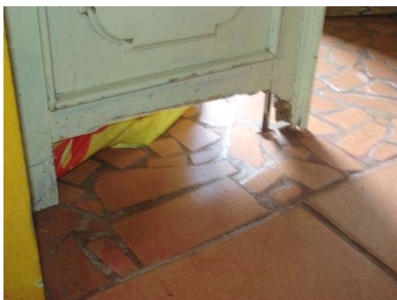
Base da porta da diretoria degradada. FOTO: Natália B.Campos, dez. 2007.
