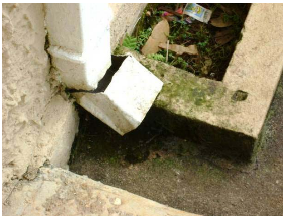
Detalhe de dano pontual em condutor de água do edifício principal.
