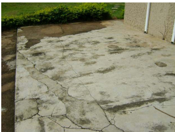
Piso cimentado no pátio, apresentando fissuras.
