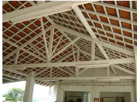
Ausência de forro na cantina.
