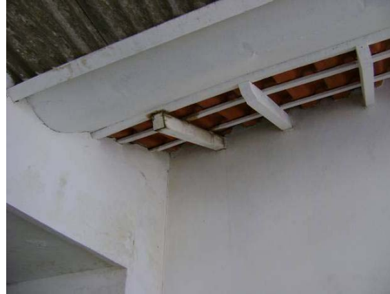
Sinal de infiltração pontual em telhas ou na calha, causando danos à seção exposta de um caibro.
