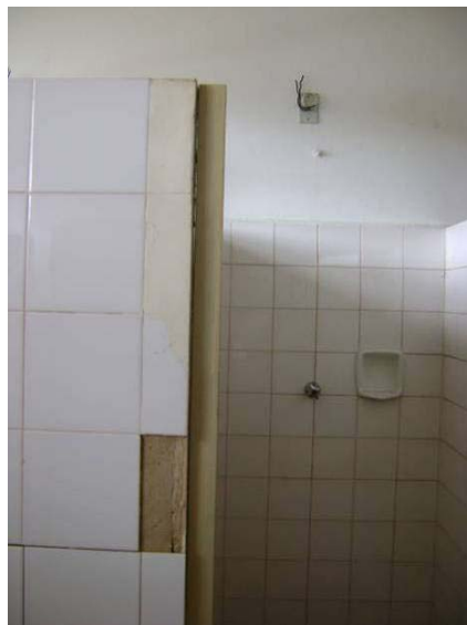
Revestimento de banheiro apresenta peças faltantes e espaços vazios cobertos por argamassa.
