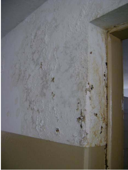
Ocorrência de empolamento com descascamento nas paredes do bloco de banheiros ao lado das salas de aula à direita do bloco principal.
