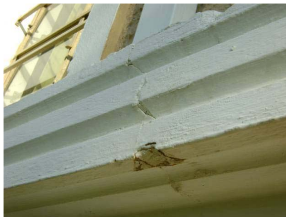
Detalhe de enquadramento de janela frontal, apresentando trinca e perda de partes da argamassa.
