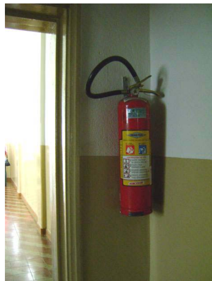
Extintor de incêndio no segundo pavimento do edifício.
