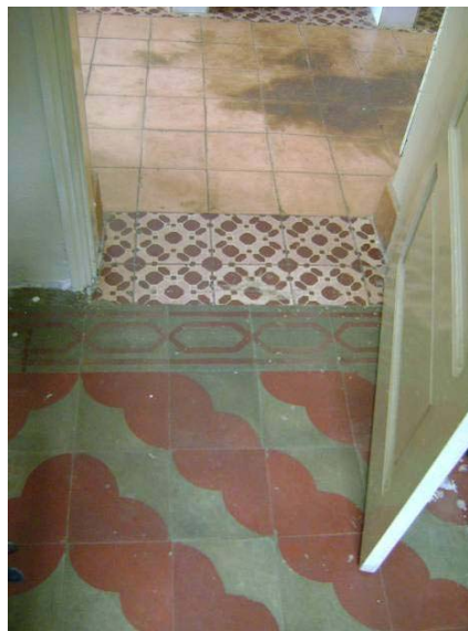
Diferentes tipologias de pisos em ladrilho hidráulico, apresentando manchas e desgaste superficial.
