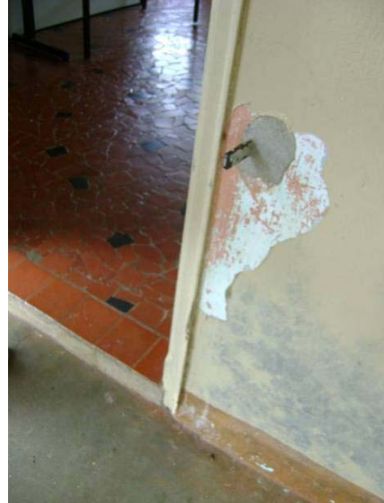
Descascamento da camada pictórica e reboco à vista - danos causados pela instalação de grades de proteção nas portas. Vê-se também manchas escuras causadas pela infiltração.
