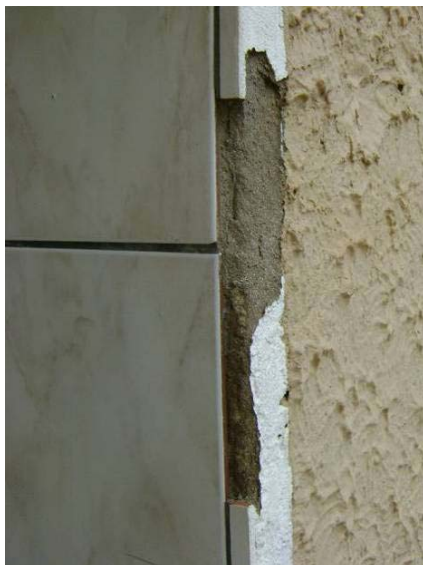
Reboco à vista em quina de parede no edifício principal da Escola Municipal Luiz de Melo Viana Sobrinho, apresentando grande perda de argamassa.
