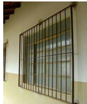
Gradil metálico de proteção das janelas de salas de aula apresentam oxidação em alguns pontos.
