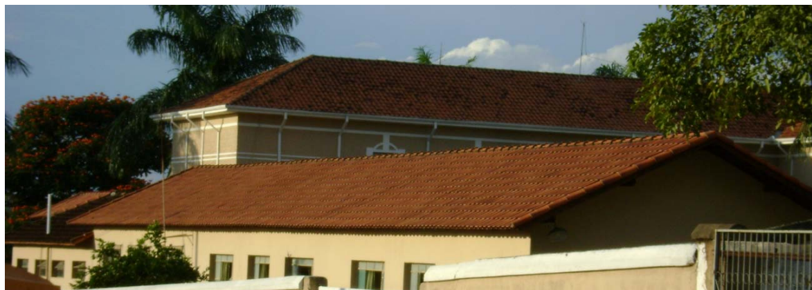
Vista das coberturas do edifício principal da antiga FEDEOP e do bloco anexo de três salas, à esquerda deste. O segundo encontra-se em melhor estado de conservação que o primeiro, em função de reforma recente.
