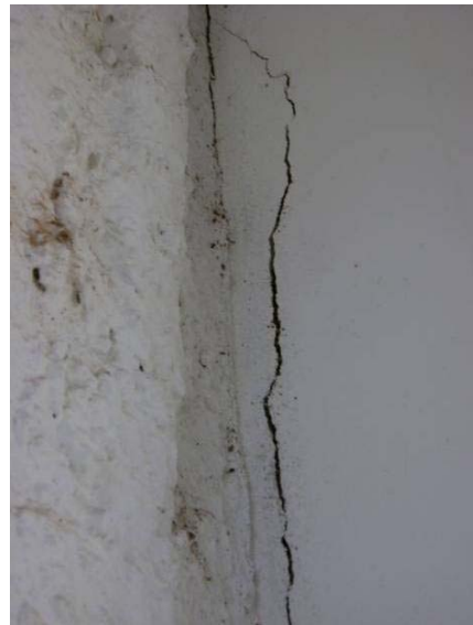
Trinca no encontro entre pilares da cantina e do prédio principal.
