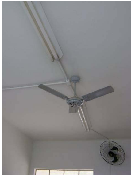
Vista de instalação elétrica no interior de um cômodo do prédio da antiga FEDEOP, em bom estado de conservação.
