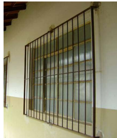
Gradil metálico de proteção das janelas de salas de aula apresenta oxidação em alguns pontos.
