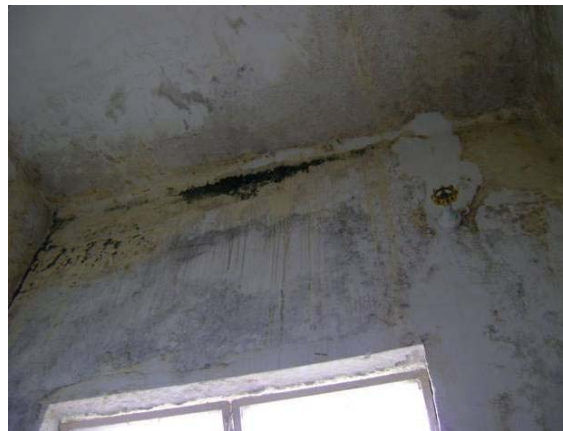
Presença de manchas escuras no interior do banheiro localizado nos fundos da biblioteca.
