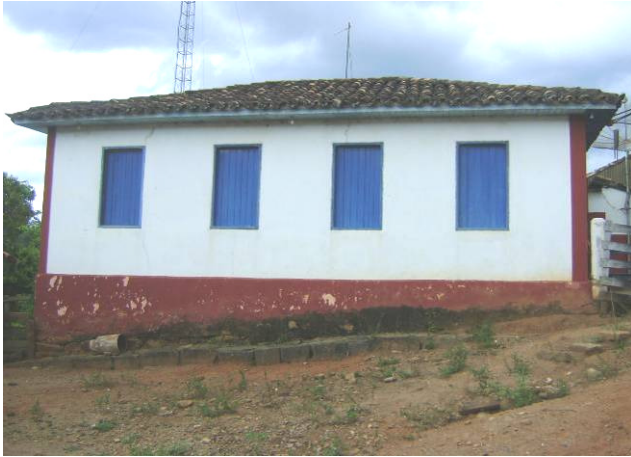
Vista da fachada lateral direita da "parte original". IMAGEM: Luiz Felipe Brito, fev/2011.
